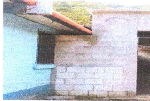
Foto 6: Sustitucion de canales se encuentra en mal estado.
